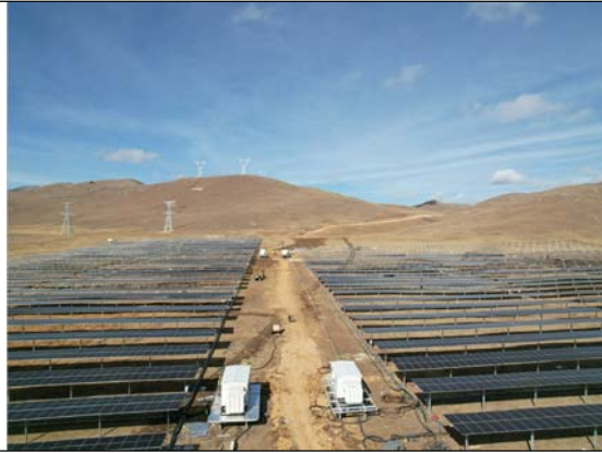
北地块光伏阵列建设现状
