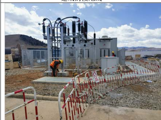
建设中的主变
