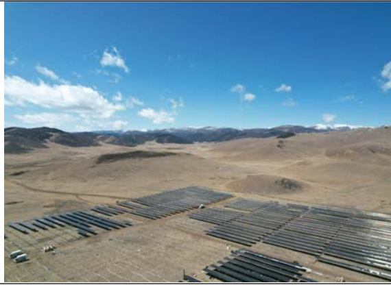
南地块光伏阵列建设现状
