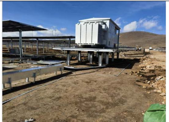
箱逆变建设现状
