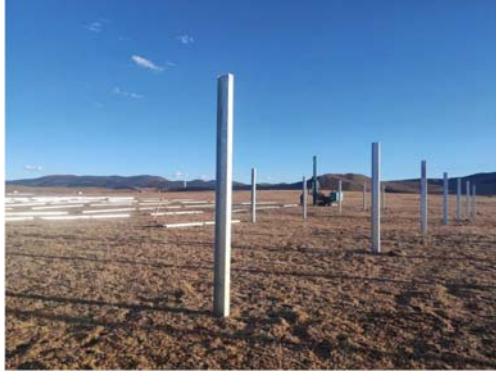
北地块静压的光伏立柱
