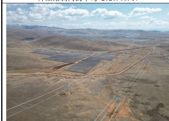
北地块光伏阵列建设情况 2023.04.19
