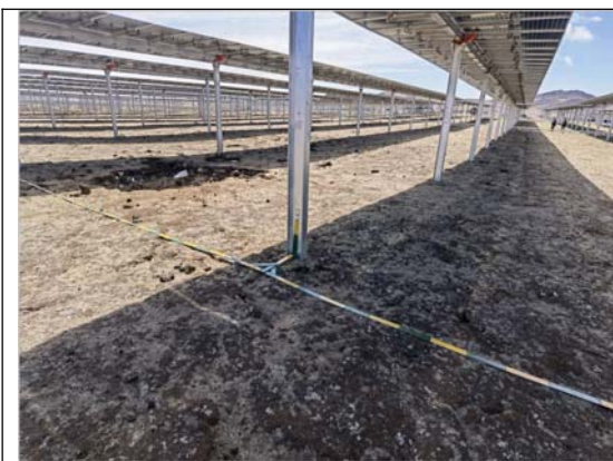
建成的接地线
