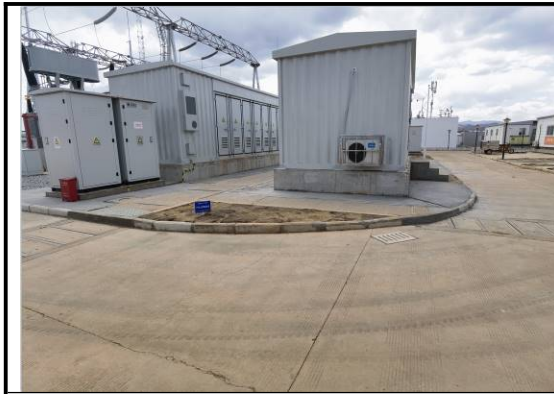
升压站 1 号监测点 2023. 04. 17
