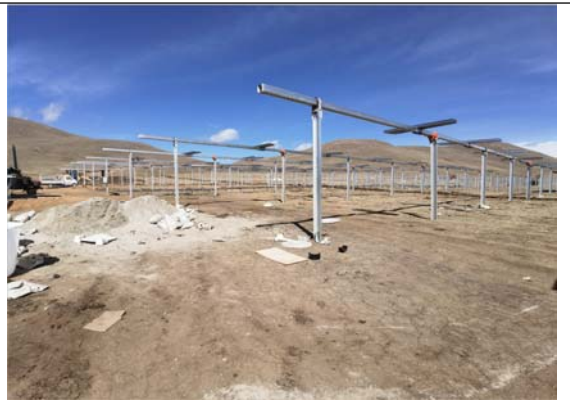
光伏组件安装现状
